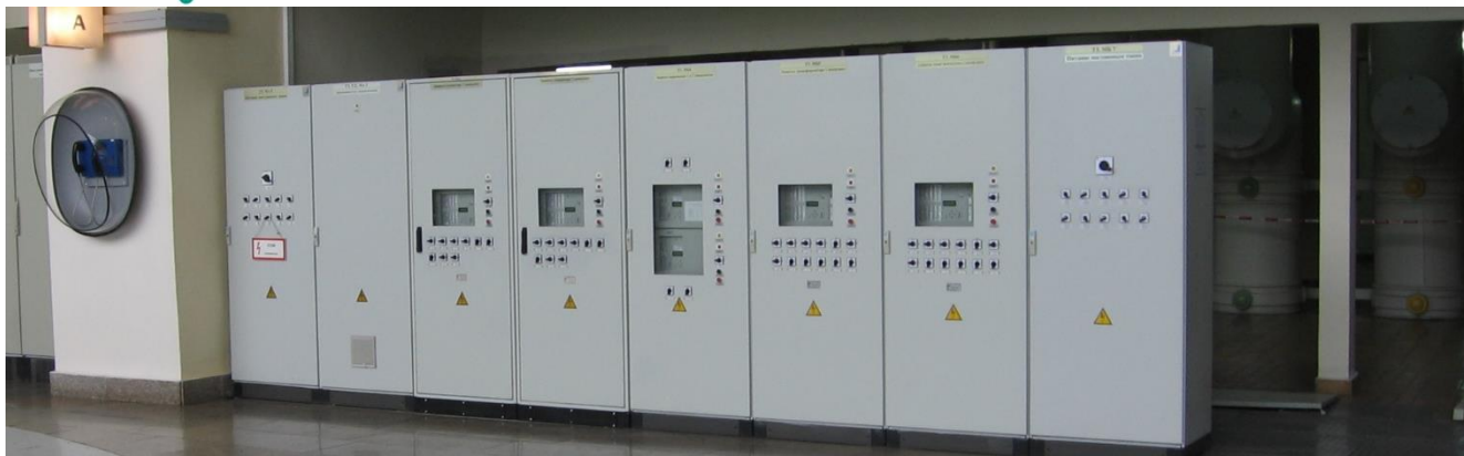
Шкафы 100 серии защиты энергоблока
