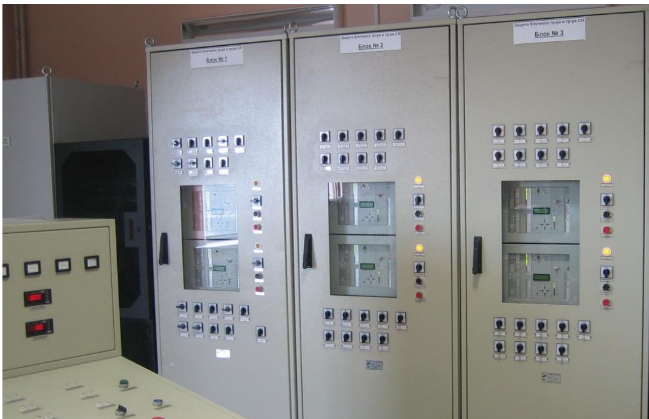
Шкафы 100 серии защиты блоков генератор-трансформатор
